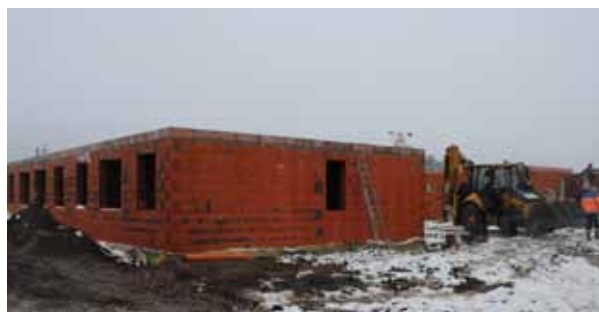
W Jezierzycach powstaną 4 nowe budynki socjalne. Trzy budynki, 6 – rodzinne i 1 budynek 12 – rodzinny. W jest również zagospodarowane terenu oraz budowa oświetlenia.
