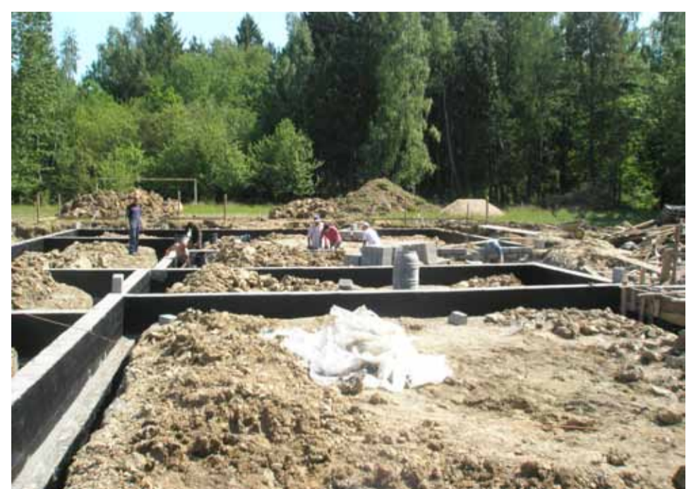
W Gałęzinowie trwa budowa świetlicy wiejskiej, przy której znajdzie się również strażnica OSP.
